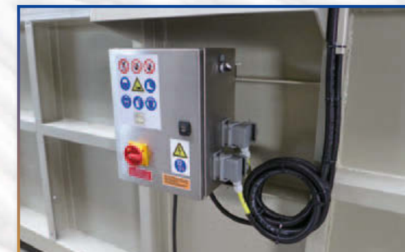
Schaltschrank mit Steuerung
